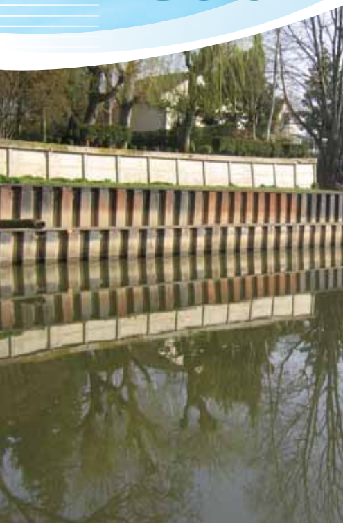
Palplanches bloquant la continuité écologique des milieux aquatiques et terrestres
